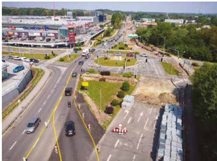
Widok z drona na przebudowywany odcinek ul. Warszawskiej pomiędzy węzłami Sarni Stok a zjazdem do Castoramy i Galerii Koniczynka, fot. MZD
