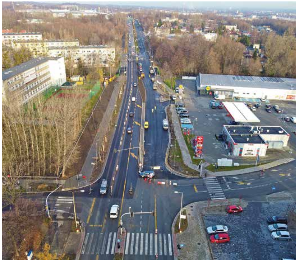
Widok z drona na przebudowywany odcinek ul. Warszawskiej nad skrzyżowaniem z ul. Budowlanych i Trakcyjną, fot. MZD
